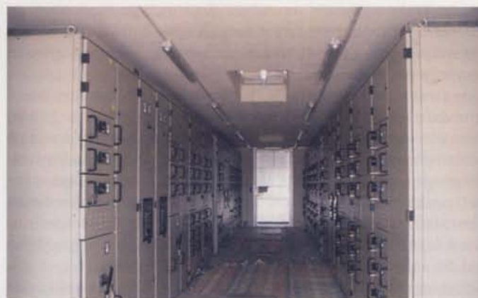
Bild 4: Niederspannungs-Schaltanlagen (Typ MoNA 5000 [7]) in der Betonstation
