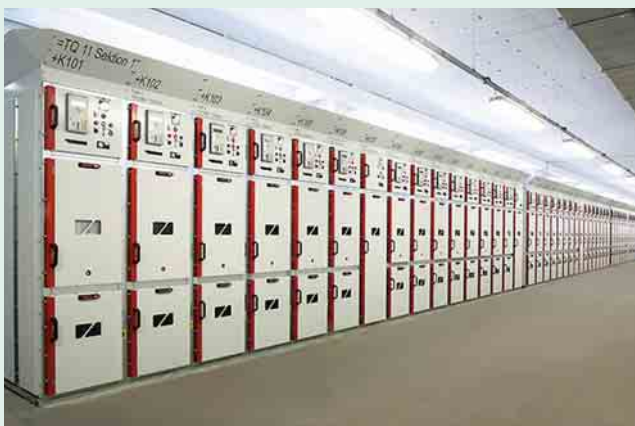
2 84 Mittelspannungs-Schaltfelder im Schaltanlagenraum
