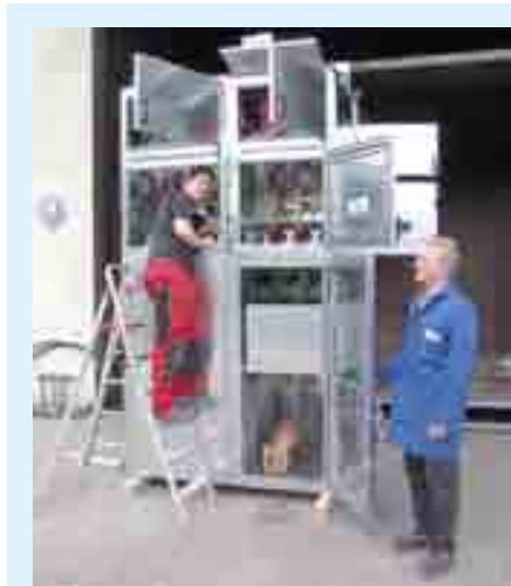
② Schaltanlage, die an zwei Feldern in vier Schotträumen geprüft wurde
