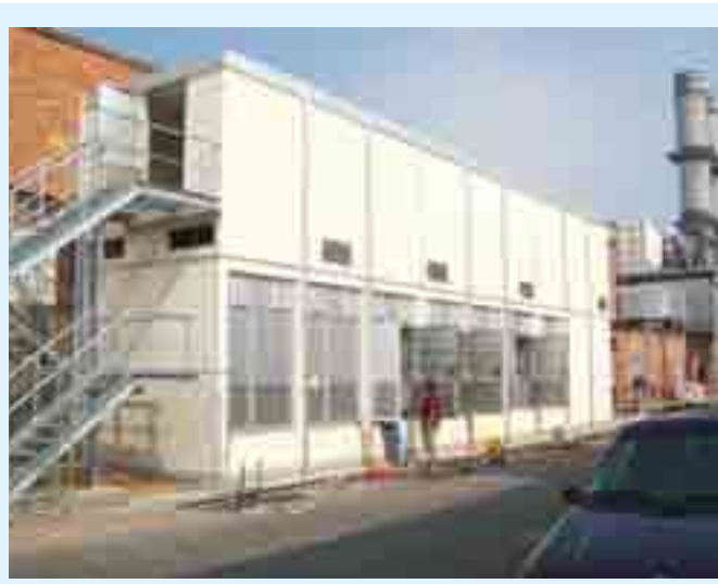
③ Beispiel für eine typgeprüfte Schaltanlage als Fertigstation ▶
