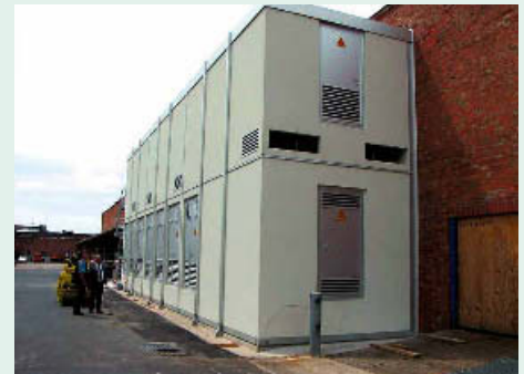
2 Betonfertigungsstationen für 7 Transformatoren 1600 kVA und 6 NS-Schaltanlagen in Einschubtechnik (MoNA 5000)
