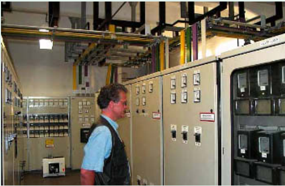
⑤ Ältere Schaltanlage mit Schienenzuführung
