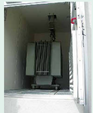
3 Transformator 1600 kVA, 6 kV/400 V, mit gießharz-isolierter Schienenverbindung (2500 A) zur Schaltanlage
