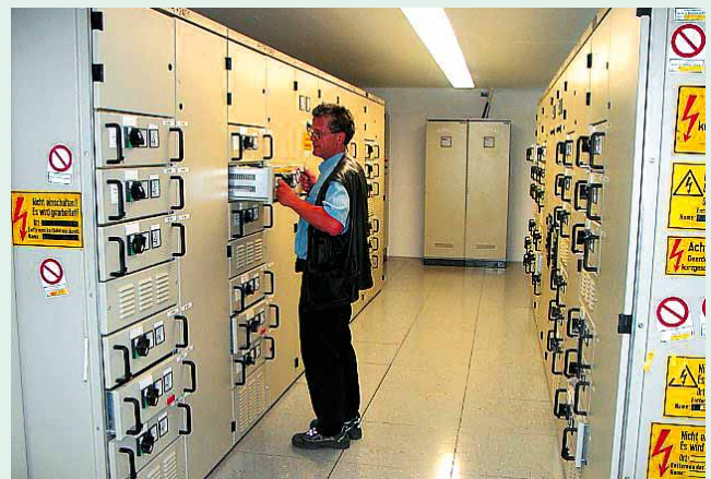
4 NS-Schaltanlage, Typ MoNA 5000 für den Kraftwerkeigenbedarf
